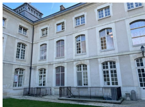
Restauration de près de 70 fenêtres. Hôpital d'instruction des Armées du Val de Grâce. Paris - 75005 - Nov. 2023 à fév. 2024
